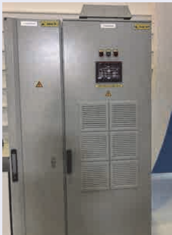
Рис. 5. Устройство бесперебойного питания (УБП-К) и батарейный кабинет (БК)
