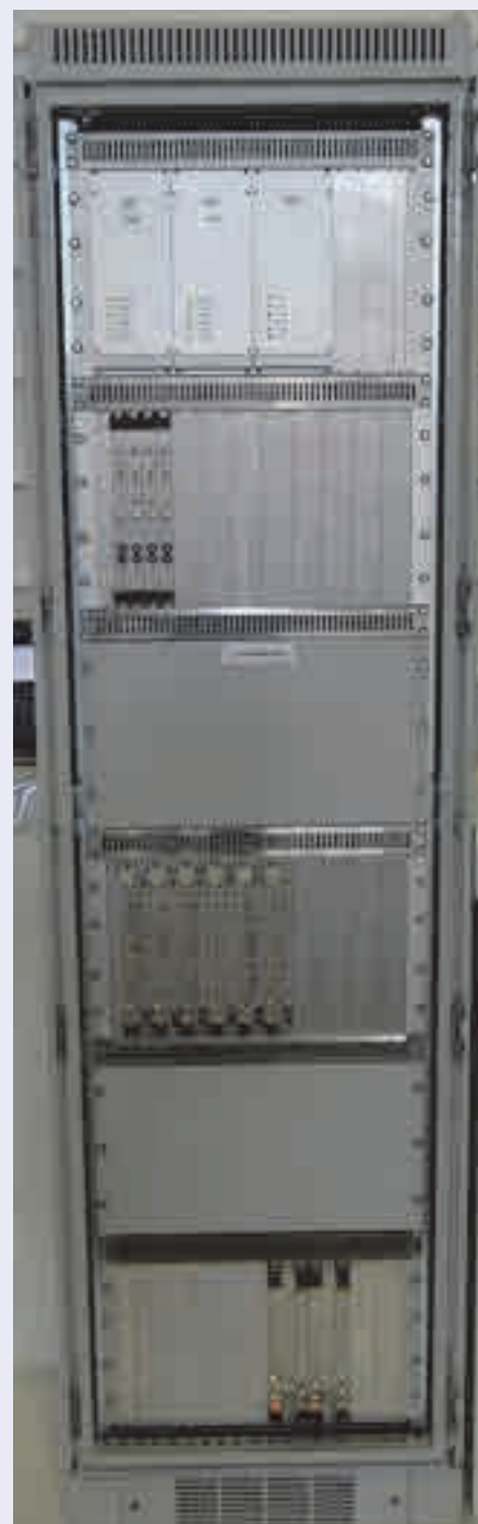
Рис. 2. Внешний вид шкафа УРЦК
