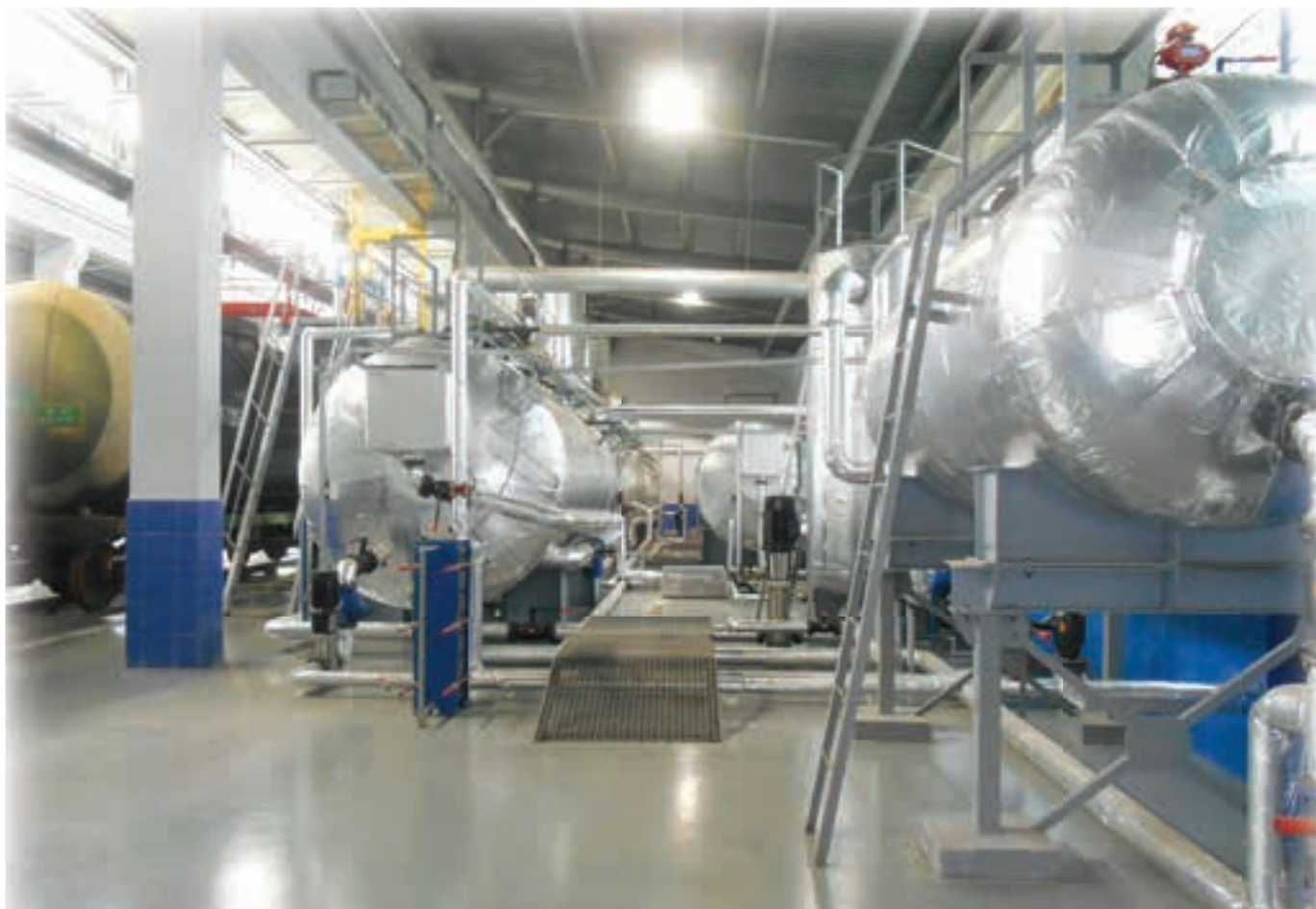
Промывочно-рециркуляционная станция в вагонном депо Верхний Уфалей
